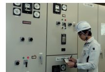
水処理施設維持管理 電気や機器が安定的に稼動するように日々の点検を行っています。
